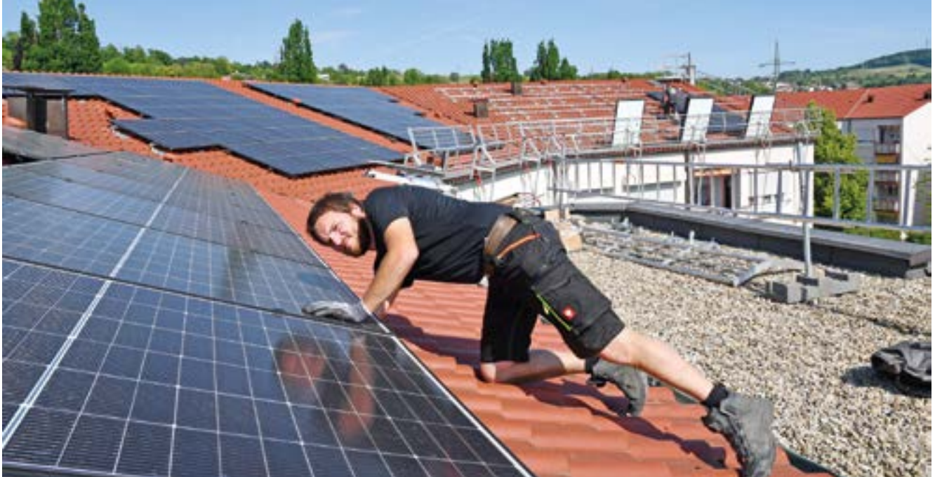
Auf den Dächern der Wölblin-Anlage sammeln nun Photovoltaik-Module die Sonne ein.
